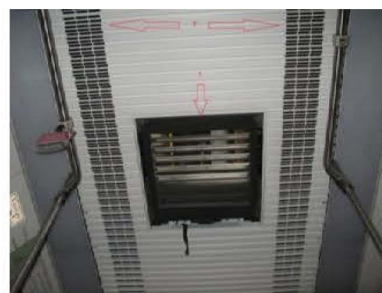
شکل ۲: دریچه‌های هوای داخل سالن : ۱- دریچه هوای برگشتی به سیستم تهویه ۲- داکت‌های هوای خروجی سیستم تهویه به داخل سالن که به صورت موازی در راستای طولی واگن از ابتدا تا انتها قرار دارند.
